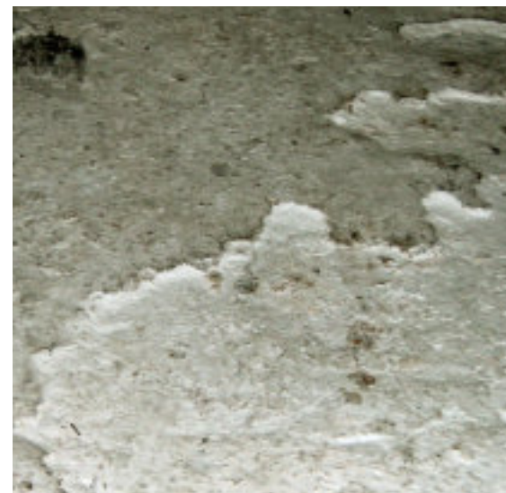
Croûte séchée de polymère, dure et compacte.
